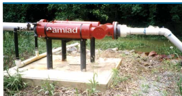
Foto 1c – Antes de retornar aos viveiros, a água bombeada passa por um filtro de telas que é autolimpante.
