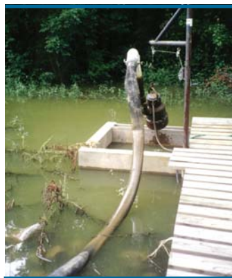
Foto 1b – Detalhe da bomba submersa que retorna a água para os viveiros. A plataforma permite o acesso à bomba e um sistema de roldanas e catraca possibilita içar a bomba para manutenção.
